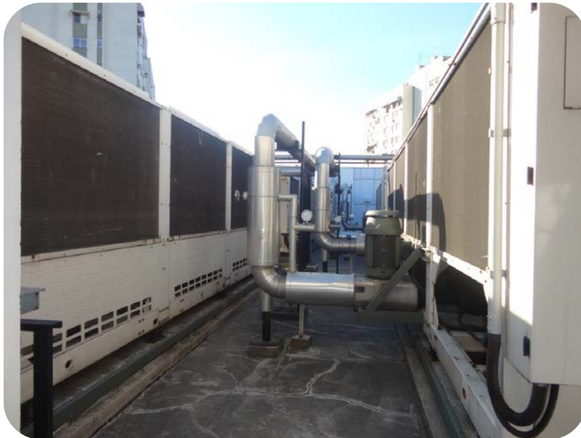
Figura 16 - Chillers de ar condicionado
