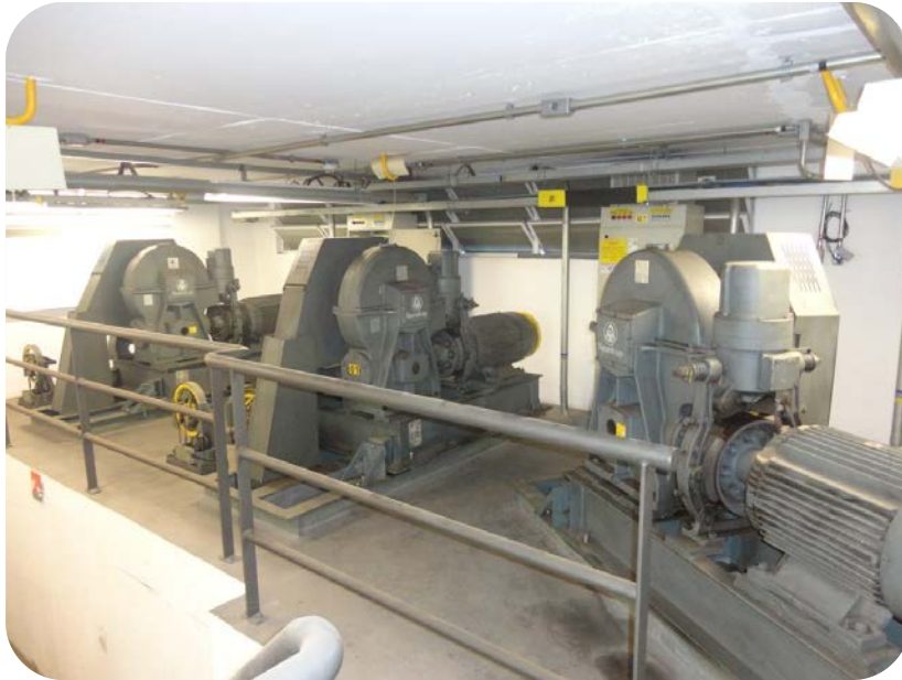
Figura 17 - Casa de máquina dos elevadores
