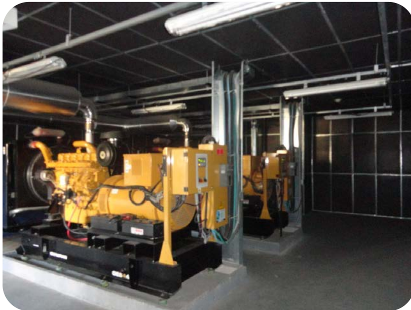
Figura 18 - Sala dos geradores
